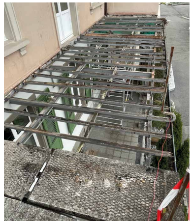
Die verrostete Terrasse müssen wir ersetzen.
